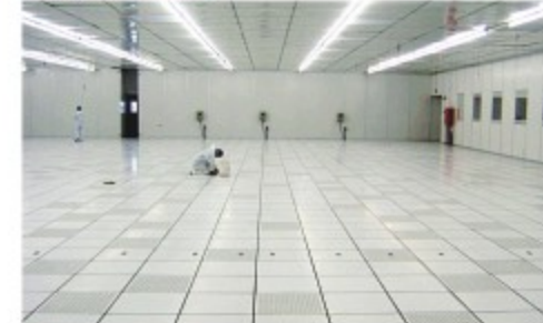
Communication center 通讯中心
