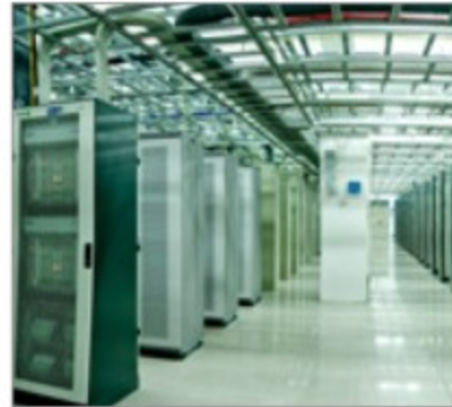
成都棕榈泉国际中心 Chengdu Palm Springs International Center 地点(Place): 成都 Chengdu 面积(Area): 50000m 2 地板类型(Panel Type): OA网络地板
